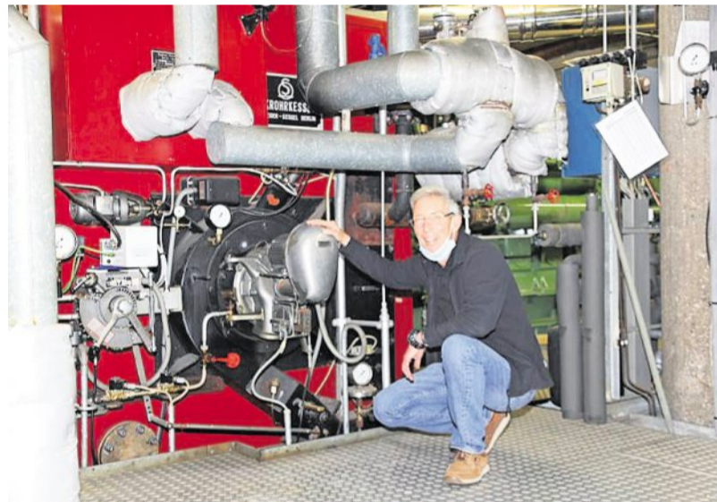
Die modernisierte Kesselanlage im Wärme-Kraft-Labor der Staatlichen Seefahrtsschule Cuxhaven. Fotos: Sassen
